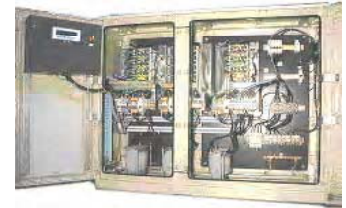
«LV Variator in cabinet»
